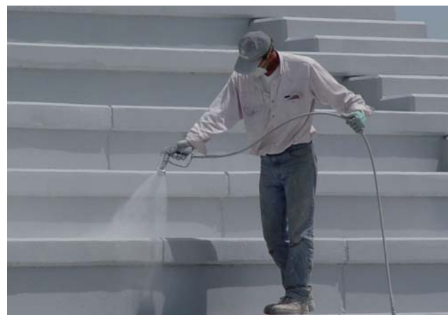
▲ Enduroof, geschikt voor waterdichting en bescherming, wordt in een stadion op het beton gespoten.
